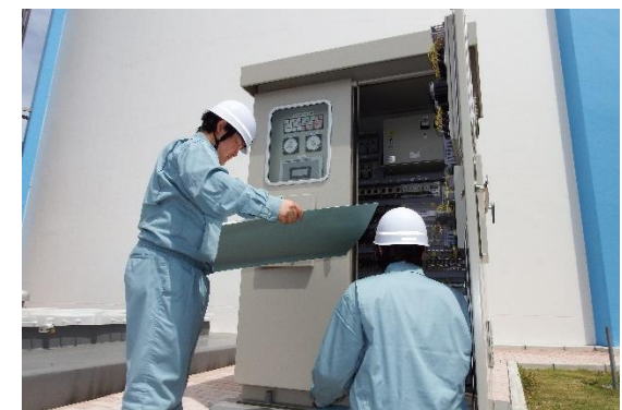
電気設備点検
